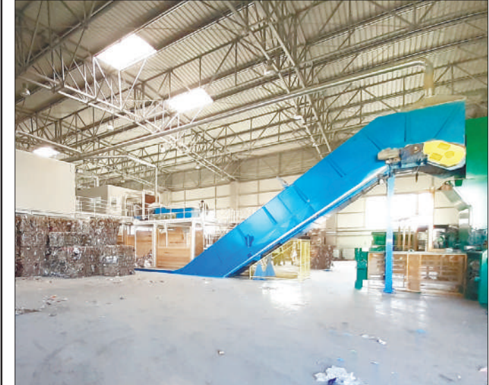
Stația de sortare a deșeurilor de la Tușora
